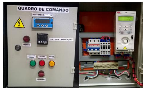
Figura 8. Quadro de comando.
