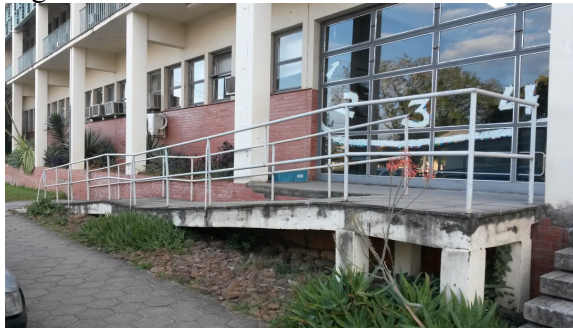
Rampa de Acesso com declividade e largura Inadequadas CCNE–UFSM (Autor, 2015)
